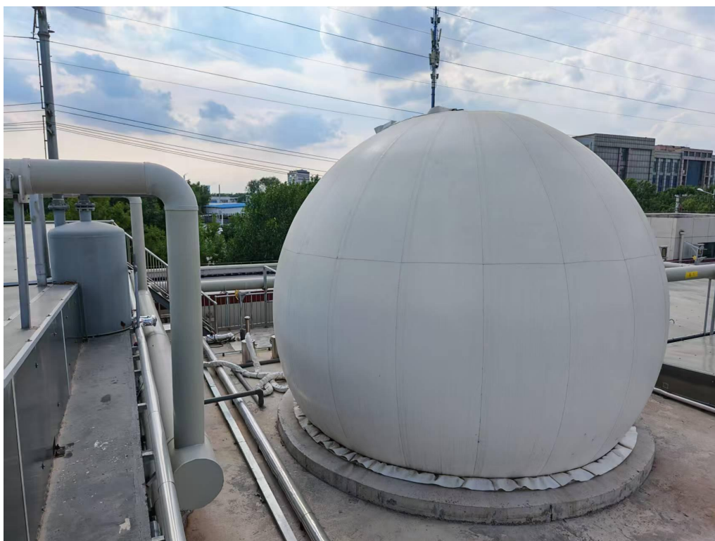
双模气柜收集沼气现场（公司污水处理站），为沼气发电及综合利用系统的沼气收集装置。
