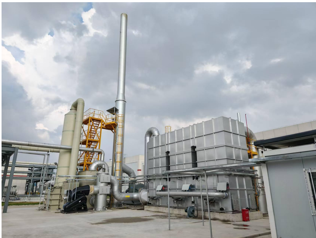
RTO 蓄热式热氧化装置（公司废气治理设施现场）。
